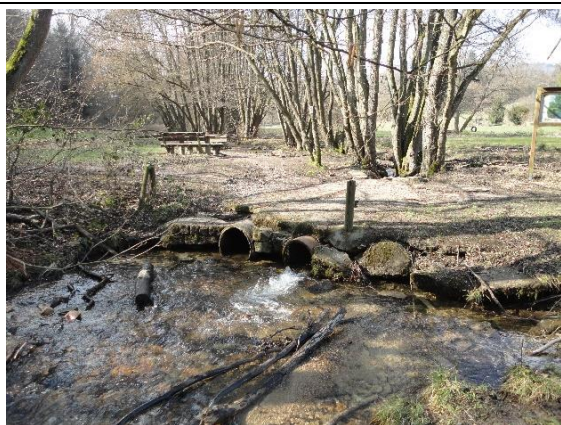
Foto 15. Bachverrohrung Flurstück 21, Flur 22
