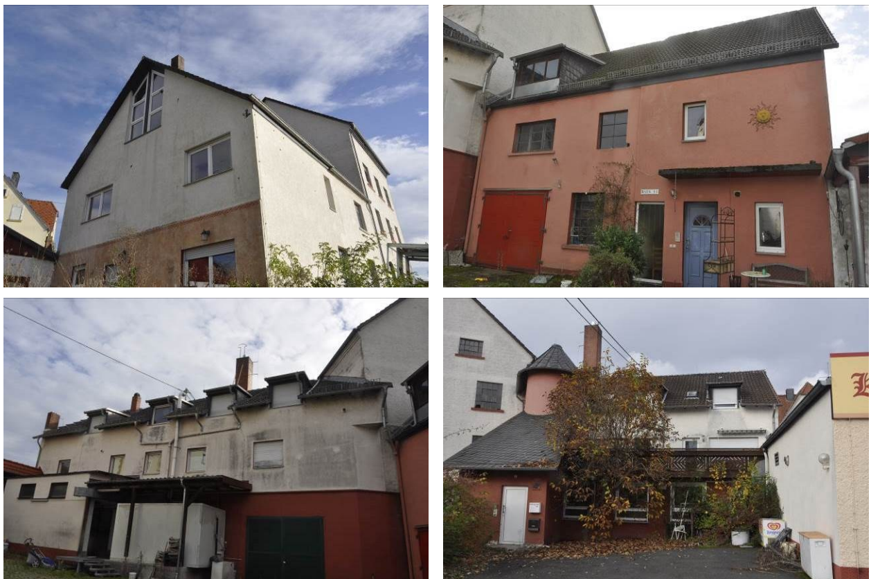
Abbildung 4: Wohnhaus und weitere Anbauten um das ehemalige Mühlengebäude herum mit Spalten am Dachüberstand und Hohlräumen in Rollladenkästen
