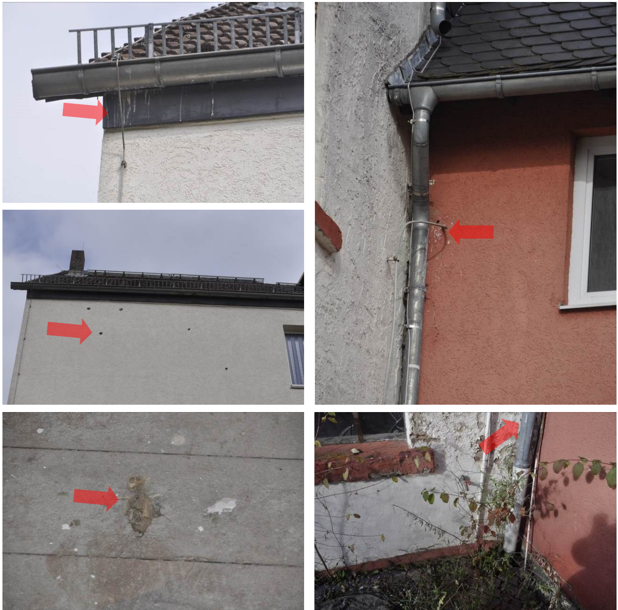
Abbildung 10: Kotspuren unter der Dachtraufe und am Fallrohr einer Dachrinne (oben-links u. rechts), Spechtlöcher in der Fassade des Wohnhauses (Mitte) und totes Taubenküken in der ehemaligen Mühle (unten), Befunde 2020/21
